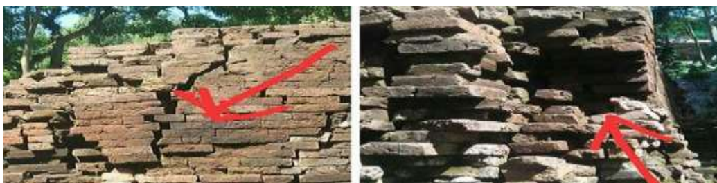
Gambar 3.10 Keretakan pada dinding candi (Dok. Afa)
